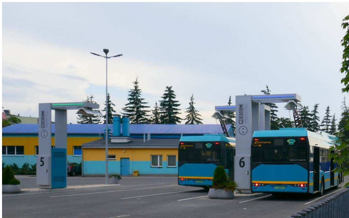
Fot. 4 Ładowanie autobusów elektrycznych na terenie zajezdni PKM Sp. z o.o.
