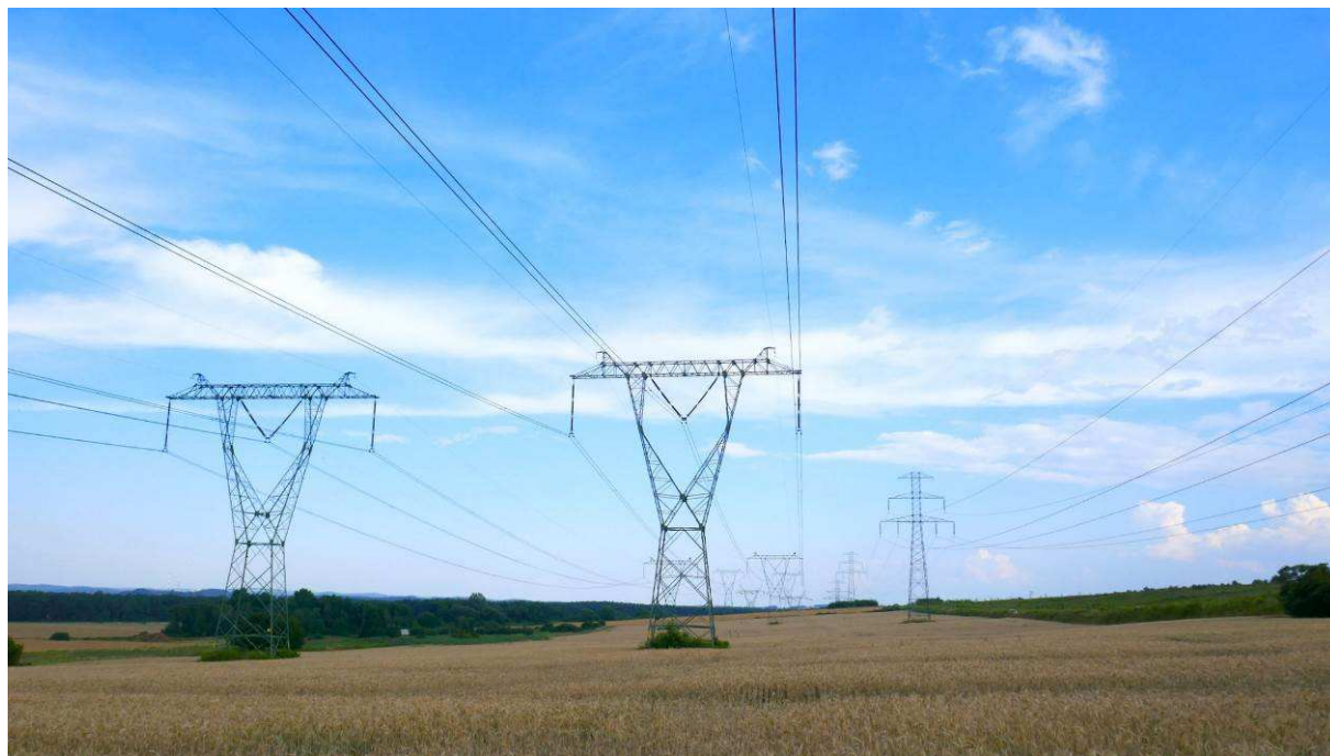
Fot. 7 Linia napowietrzna najwyższego napięcia 400kV
