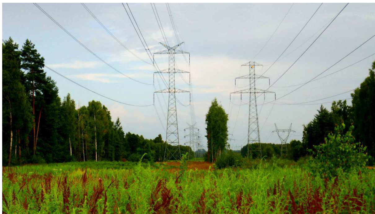
Fot. 8 Linia napowietrzna najwyższego napięcia 220kV
